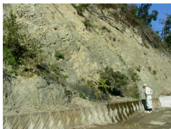
図-15 津山26の崩壊地で見られた湧水
