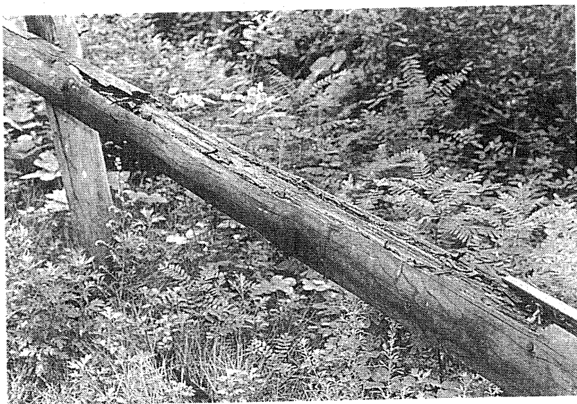
写真6 褐色腐朽菌による 被害
