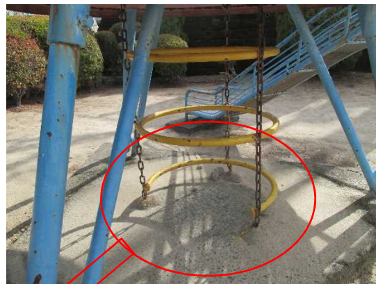
コンクリートの露出状況
